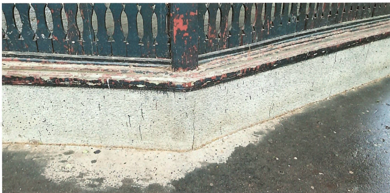
Figura 15. Fundație fisurata la foisor
