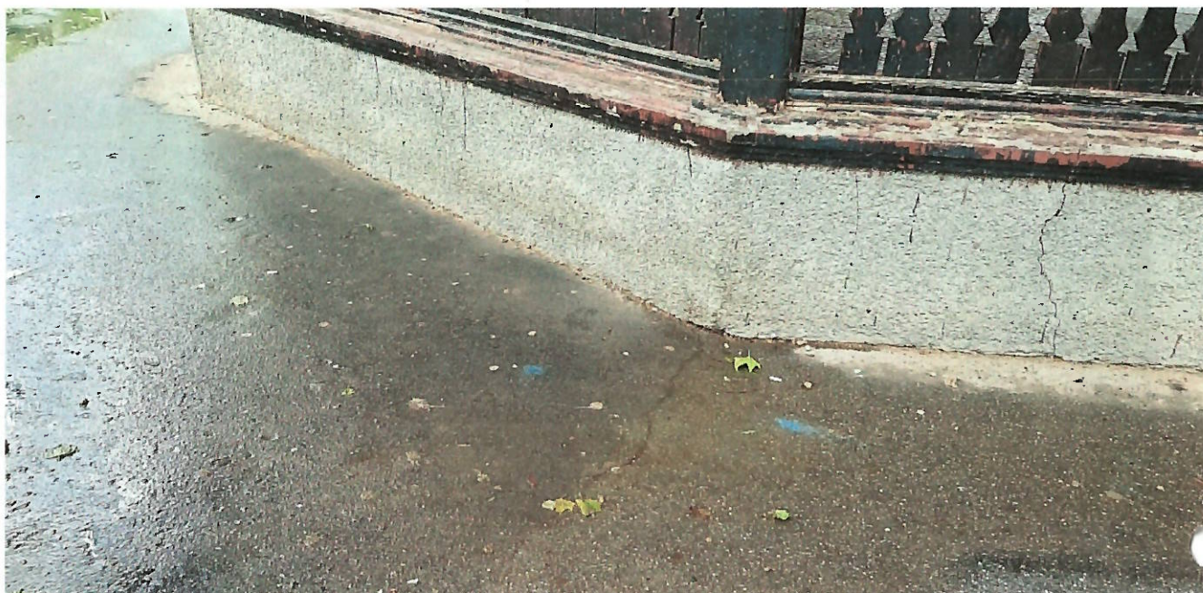
Figura 16. Fundație fisurată la foișor
