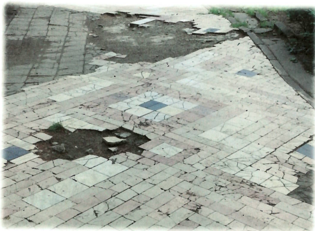
Zona cale pietonala - pavaj dale piatra (elemente lipsa, plombari cu alte materiale, suprafata neregulata, tasari)
