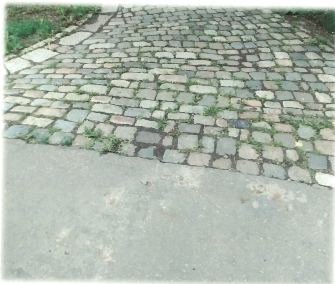
Zona imbinare cale pietonala asfalt - pavaj piatra (suprafata neregulata)
