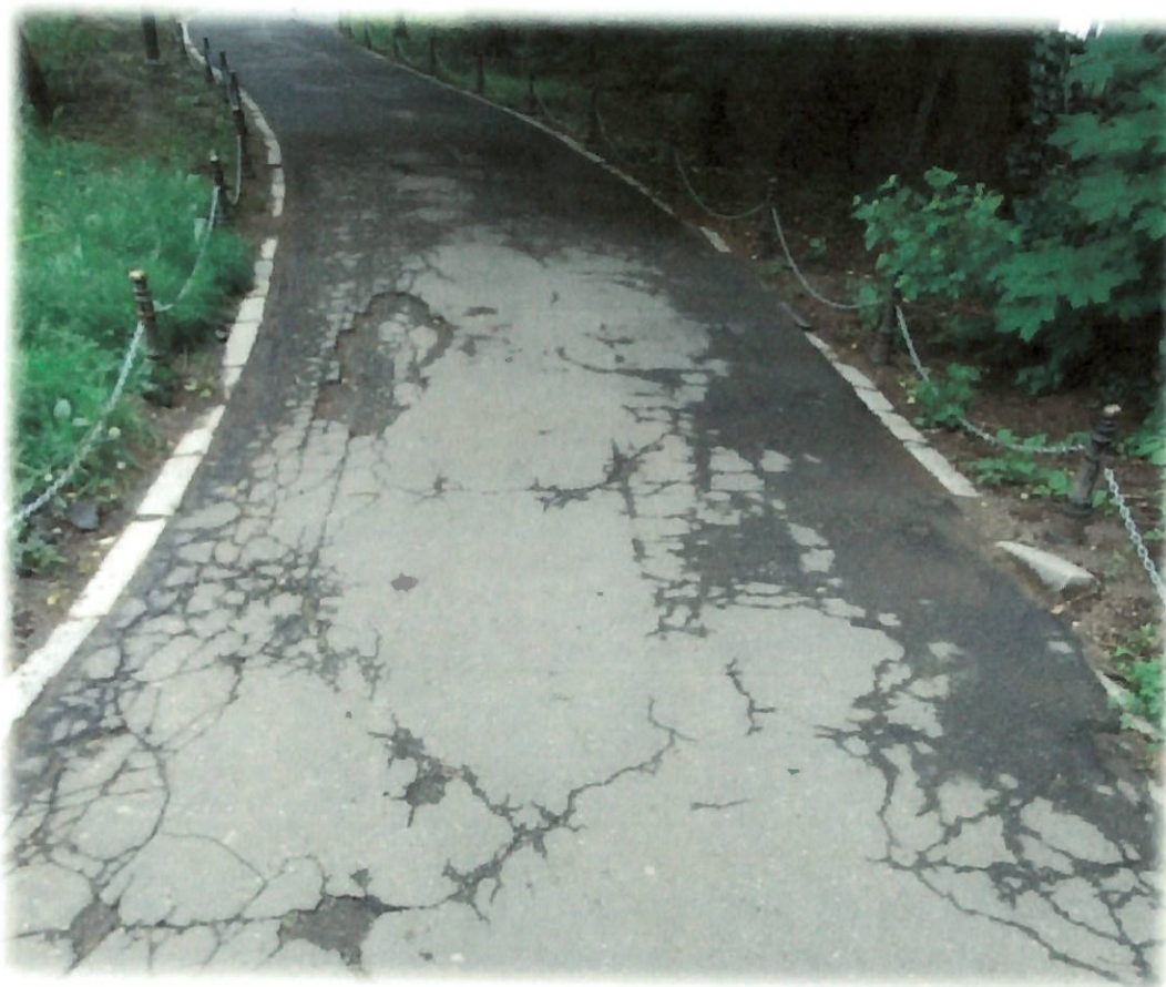
Stare generala asfalt degradata - faiantari, exfolieri, scurgere deficitara ape meteorice
