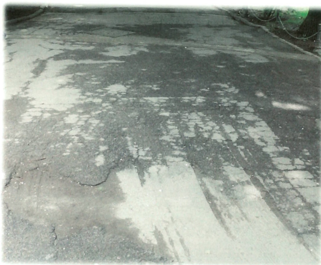
Stare generala asfalt degradata - faiantari, cedari fundatie
