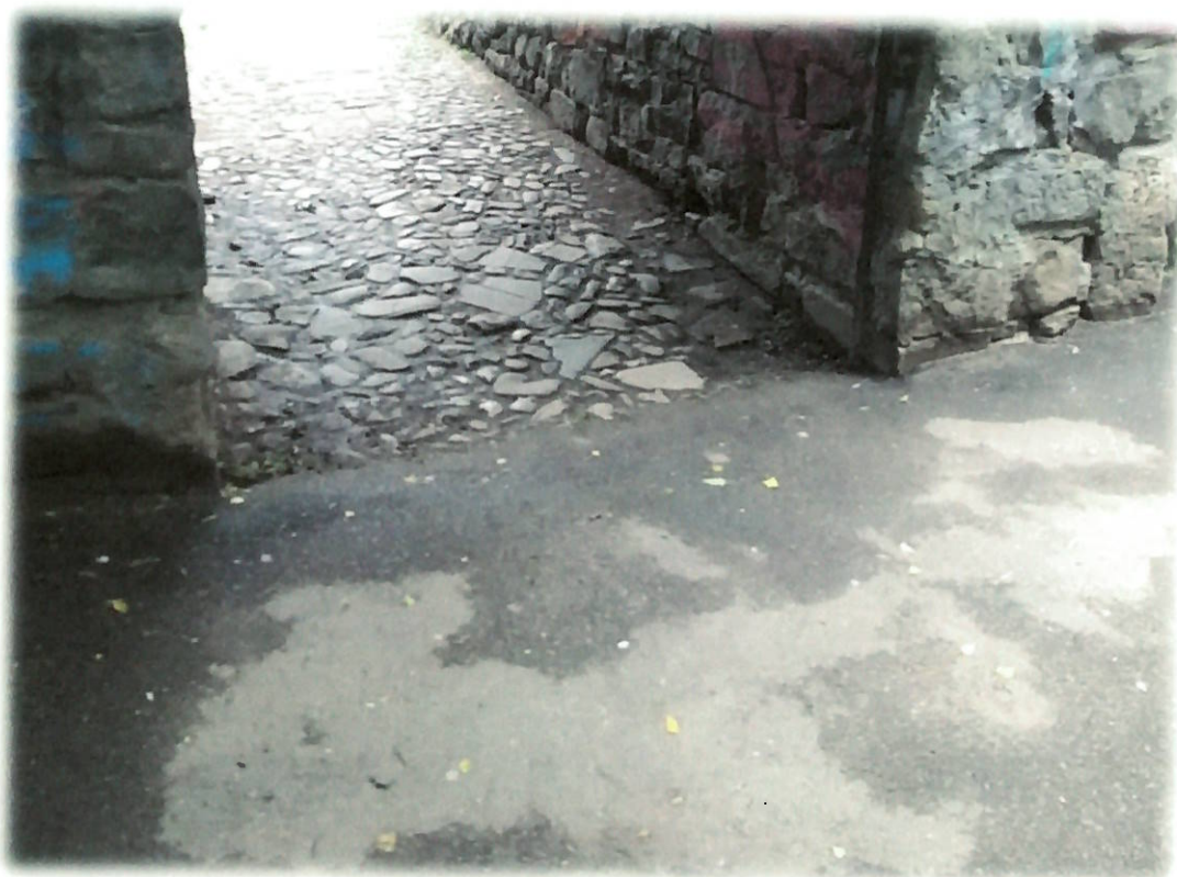
Zona imbinare cale pietonala asfalt - pavaj piatra (suprafata neregulata)
