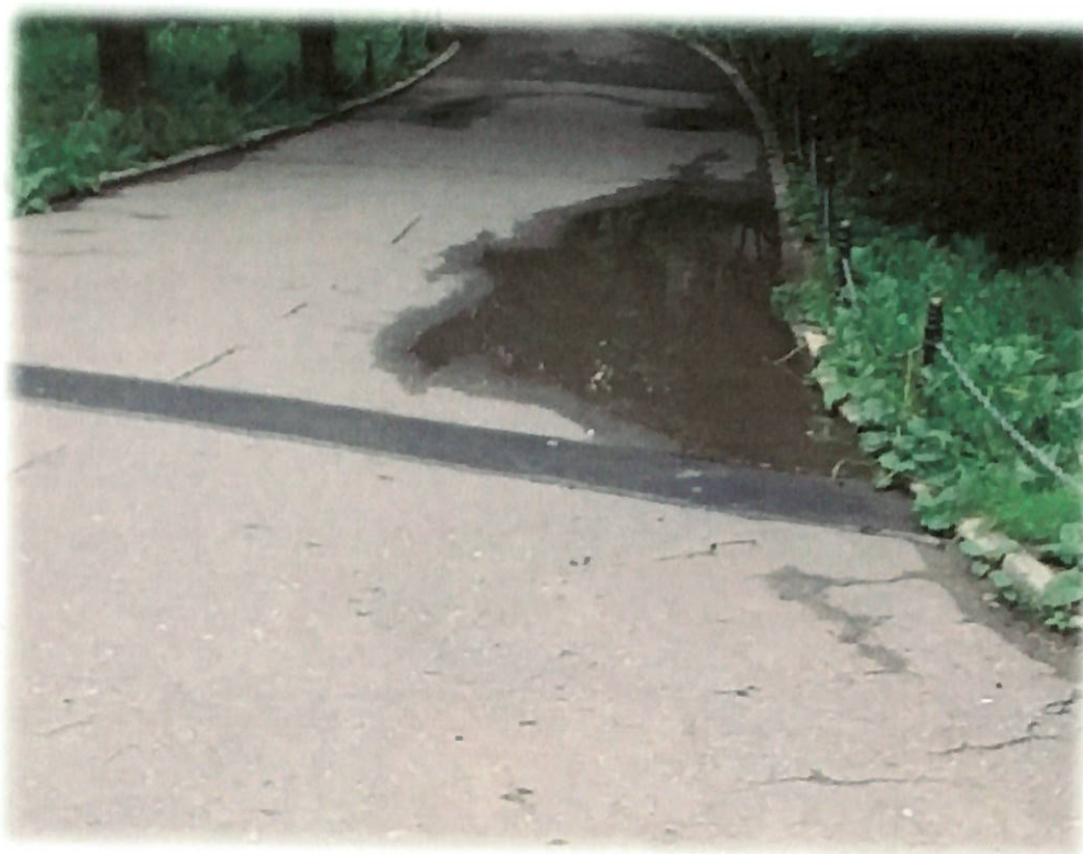
Scurgere deficitară a apei meteorice, plombări zone intervenții utilități
