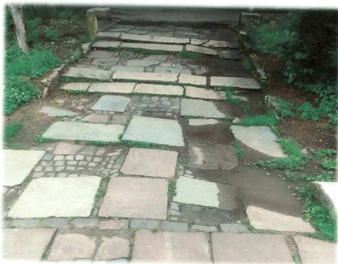
Zona cale pietonala - pavaj piatra (suprafata neregulata, degradari, cedari fundatie)
