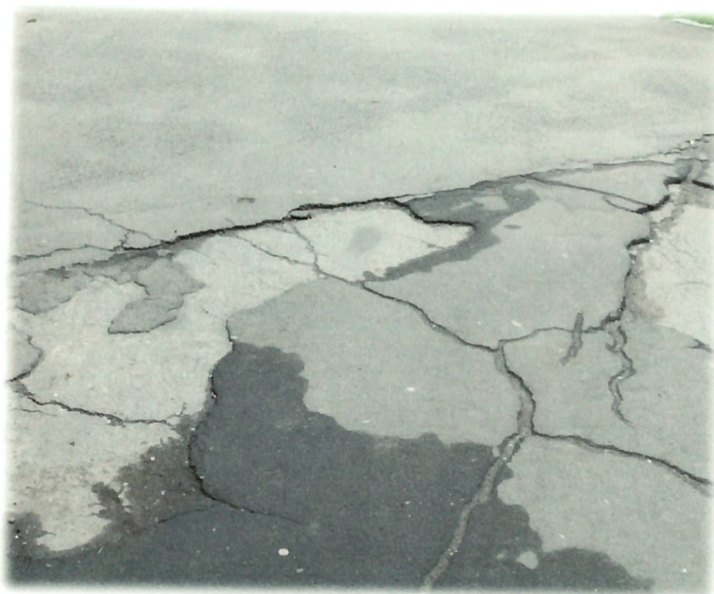
Stare generala asfalt degradata - fisuri, faiantari, exfolieri
