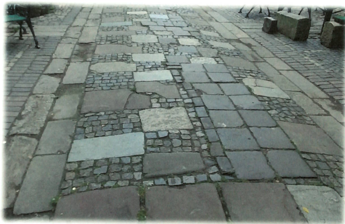
Zona cale pietonala - pavaj piatra (suprafata neregulata, degradari)
