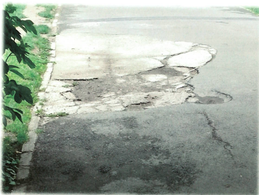
Stare generala asfalt degradata - faiantari, plombari cu beton, gropi, cedari fundatie
