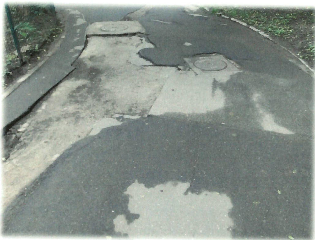
Stare generala asfalt degradata - faiantari, exfolieri, gropi
