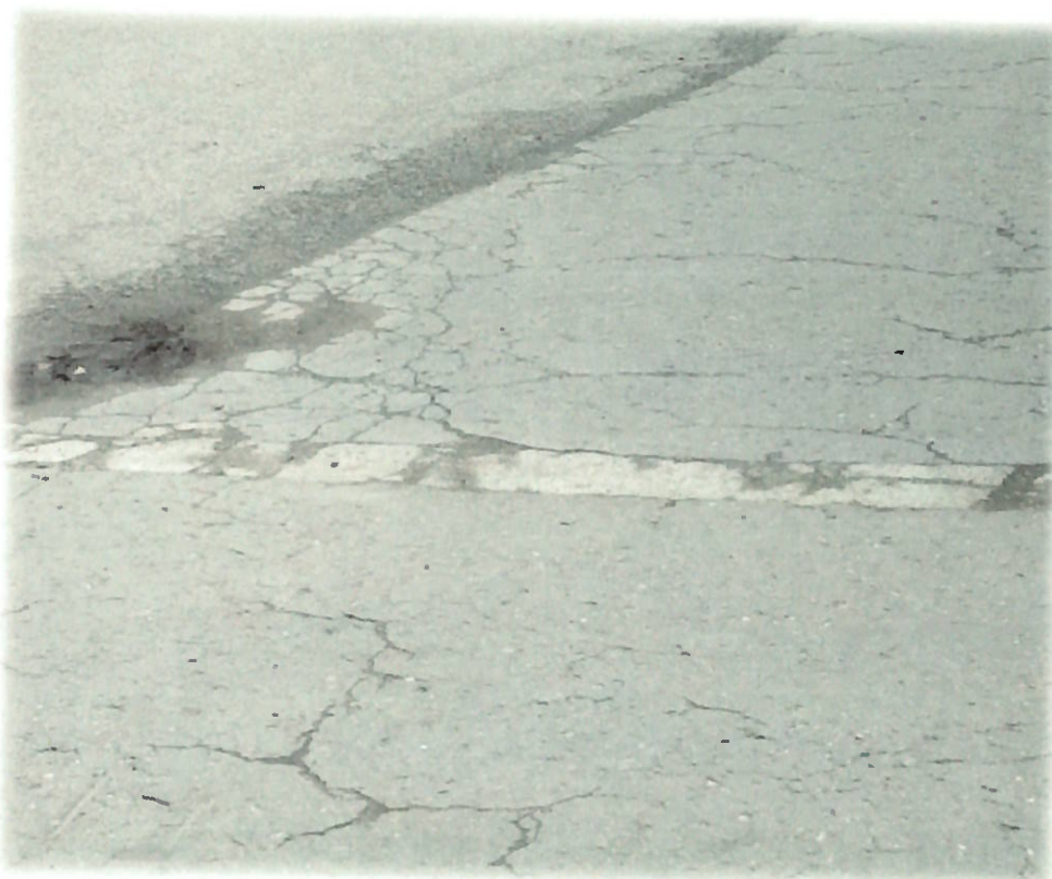
Scurgere deficitara ape meteorice, faiantari, cedari fundatie, plombari zone interventii utilitati
