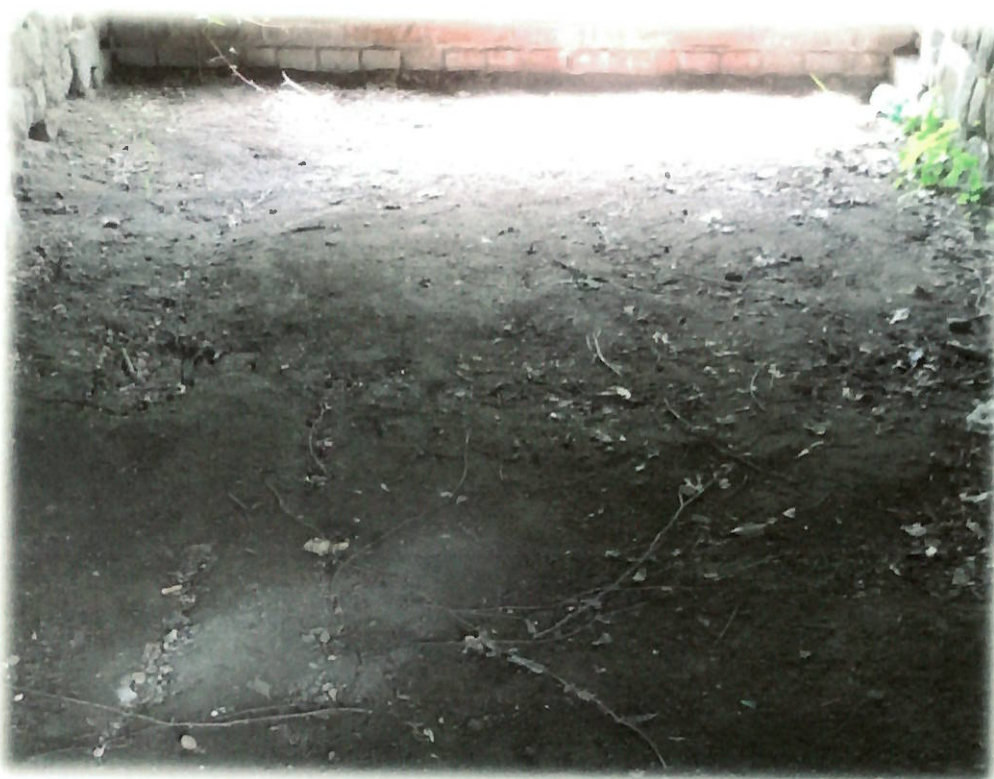
Zona cale pietonala - pavaj piatra (elemente lipsa, suprafata neregulata)
